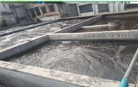
13) Sludge Return Tank
