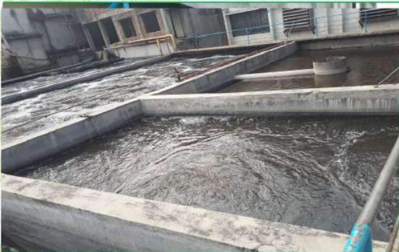
13) Sludge Return Tank
